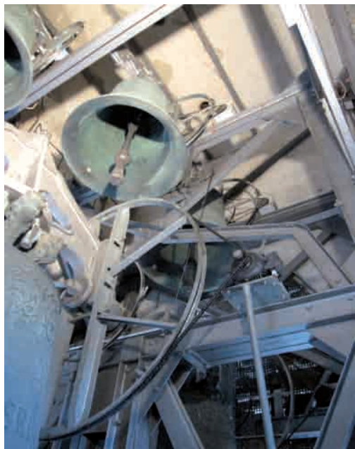
Glockenstuhl in Stahl, Predigerkirche Zürich
